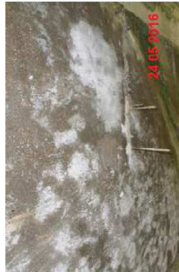
Foto 7. Fissura com eflorescência na laje em balanço.
