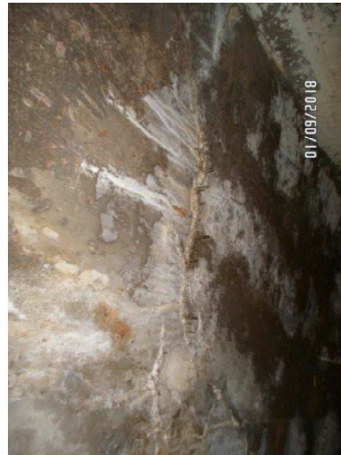
Foto 7. Fissura com eflorescência na laje.
