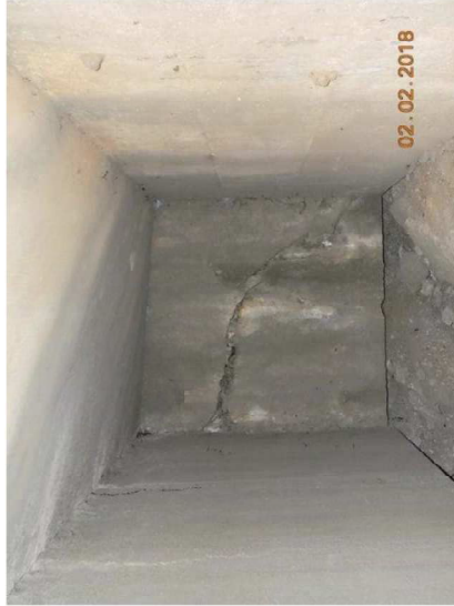
Foto 6. Ruptura/fissura na cortina.
