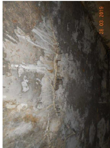
Foto 7. Fissura com eflorescência na laje.
