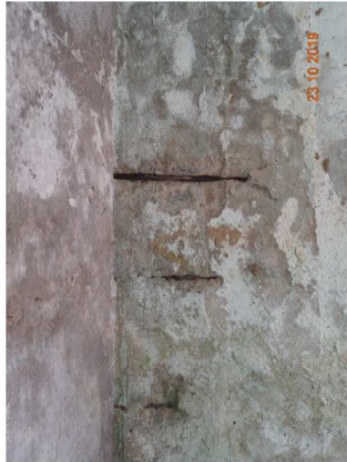
Foto 5. Concreto disgregado com armadura exposta e corroida na viga longitudinal.
