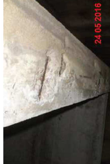
Foto 8. Concreto disgregado com armadura exposta e corroída na viga longitudinal - face inferior.
