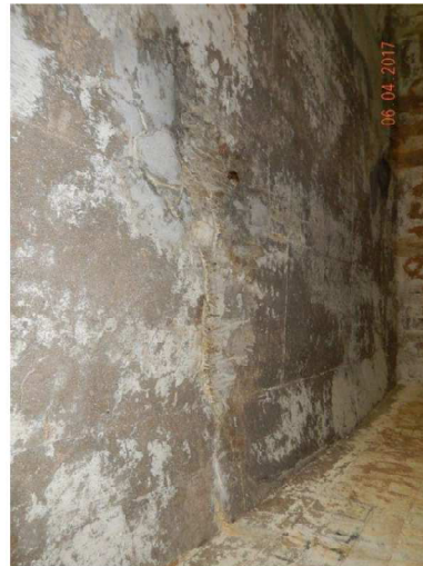
Foto 7. Fissura com eflorescência na laje.
