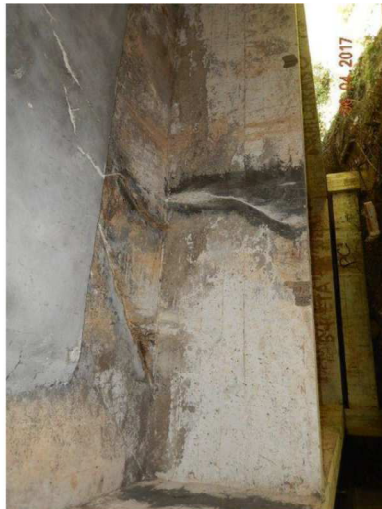
Foto 5. Fissura com eflorescência na laje e viga transversina.
