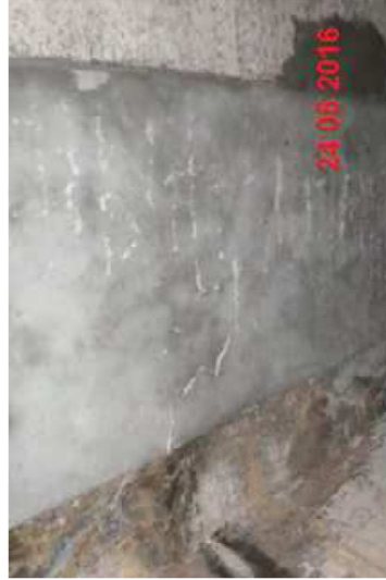
Foto 6. Fissuras com eflorescência no reparo executado na laje.
