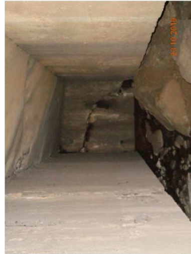
Foto 7. Ruptura/fissura na cortina.
