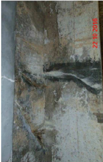
Foto 5. Fissura com eflorescência na laje e viga transversina.
