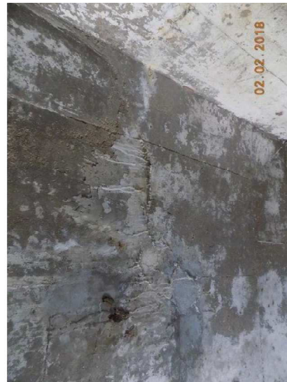
Foto 7. Fissura com eflorescência na laje.
