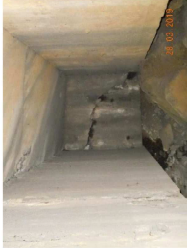
Foto 6. Ruptura/fissura na cortina.
