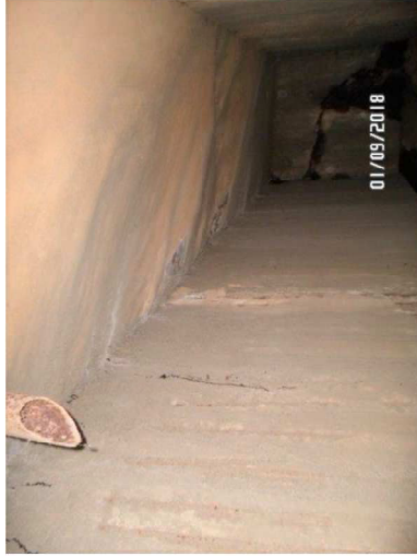
Foto 6. Ruptura/fissura na cortina.
