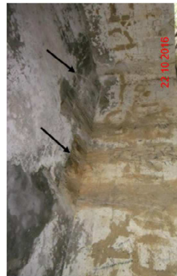
Foto 7. Fissura com eflorescência e escorrimento de umidade na laje - face inferior.
