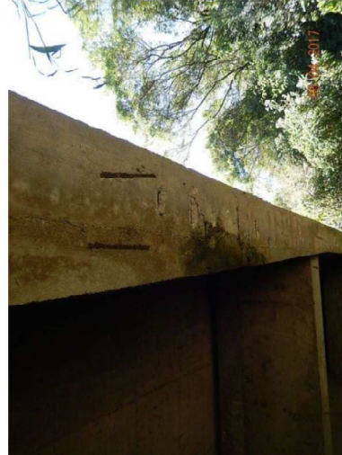
Foto 8. Concreto disgregado com armadura exposta e corroída na viga longitudinal - face inferior.
