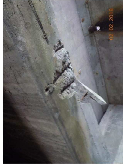
Foto 8. Concreto disgregado com armadura exposta e corroída na viga longitudinal - face inferior.
