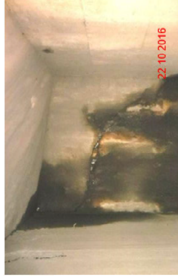
Foto 6. Ruptura/fissura com eflorescência na cortina.
