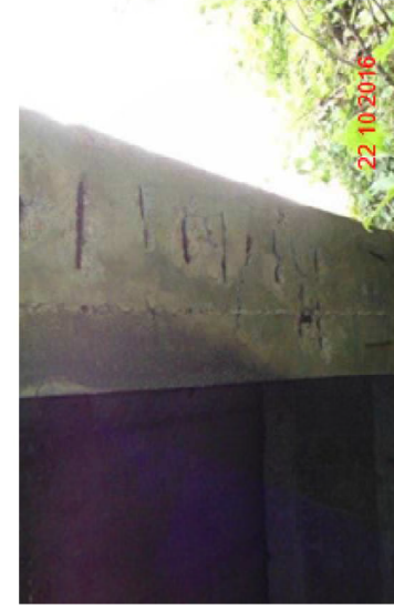
Foto 8. Concreto disgregado com armadura exposta e corroída na viga longitudinal - face inferior.
