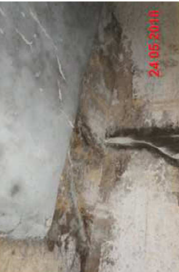
Foto 5. Fissura com eflorescência na laje e viga transversina.
