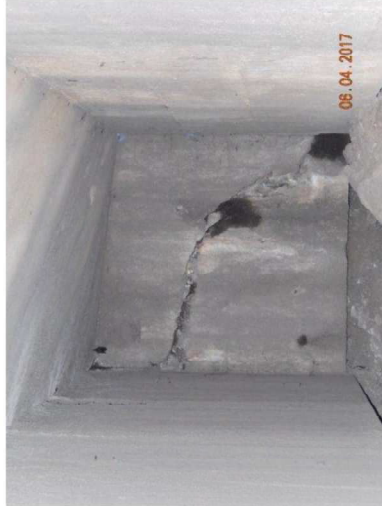
Foto 6. Ruptura/fissura na cortina.
