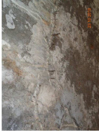
Foto 6. Fissura com efflorescência na laje.
